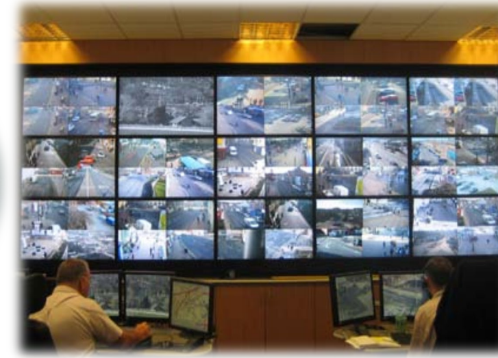
ระบบควบคุมการจราจร
