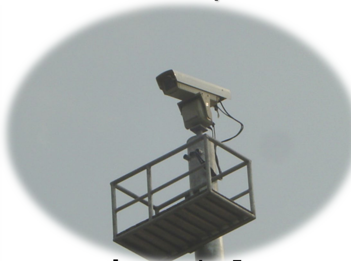
ระบบกล้องโทรทัศน์วงจรปิด
